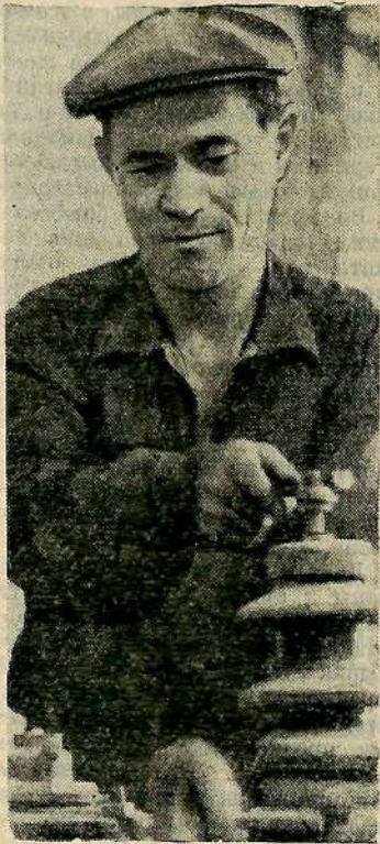
Передовой электромонтер электроцеха комбината искусственного волокна Яков Петрович Луценко за ремонтом трансформатора.
