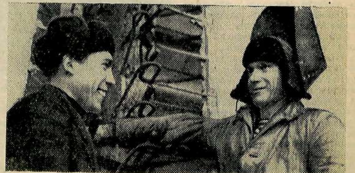
Хорошо трудится на монтаже кислотной станции комбината искусственного волокна бригада Павла Минакова.
