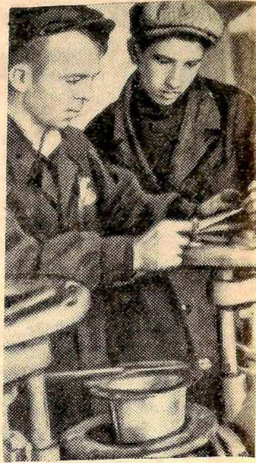
Монтажники тт. Лучин и Кишин монтируют трубу в цехе вискозы комбината искусственного волокна.
