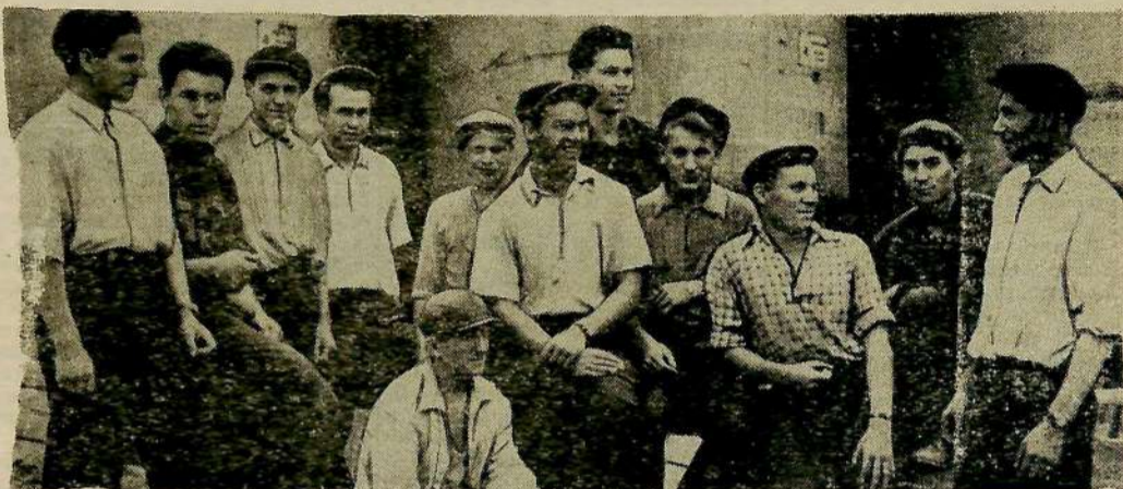
Бригада коммунистического труда, руководимая тов. Минеевым, ведет работы нулевого задела на корпусе вискозы комбината искусственного волокна. Ее коллектив готовит фунда-
