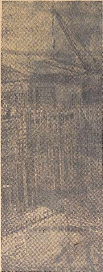
Правобережная монтажная площадка строительства Саратовской ГЭС. Она сейчас — самый напряженный объект строительства седьмой Волжской. Фото М. БАБЕНКО.
