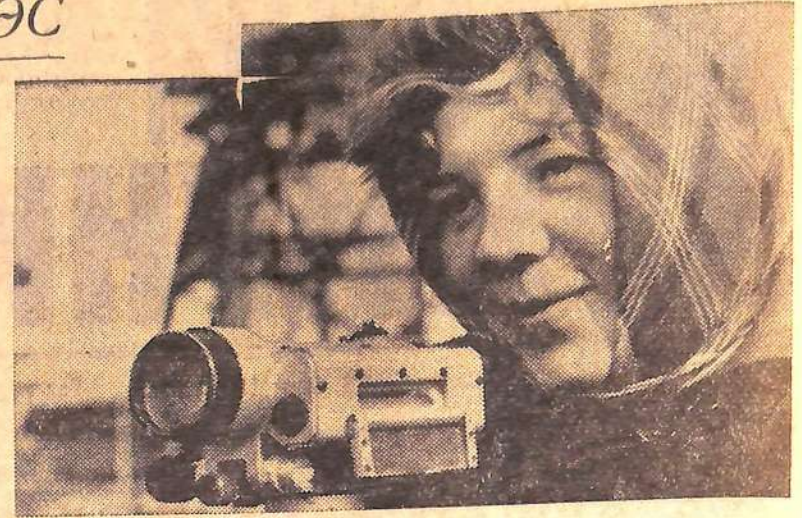
Рабочая Галия Иванова помогает техникам и инженерам проводить геодезические работы в котловане гидроэлектростанции.
