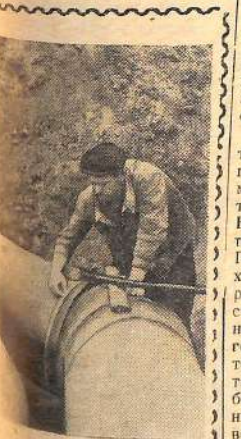
Современные модели остались на стадии эксплуатации теплотрассы, идущей от ТЭЦ в Саратовский городок строителей. Высокие образцы труда показаны сейчас на центровке № 72 В. Г. Хромов. Задание выполнено перевыполняет на 50-70 процентов, а качество работы отличное.
