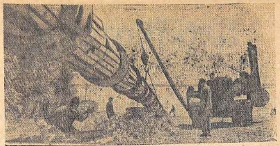
Татарская АССР. Горячие дни у строителей газопровода Миннибаево—Казань. Они обязались в нынешнем году ввести в строй вторую нитку этой очень важной артерии, питающей столицу Татарии дешевым голубым топливом. На снимке: бригада трубукладчиков, возглавляемая Николаем Красновым.
