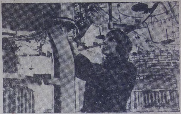
Новый производственный корпус, предназначенный для изготовления формоустойчивого трикотажного полотна, вступает в строй в Московском объединении по выпуску верхнего трикотажа. В нем установлено высокопроизводительное вязальное оборудование и три стабилизационно-отделочные линии.
