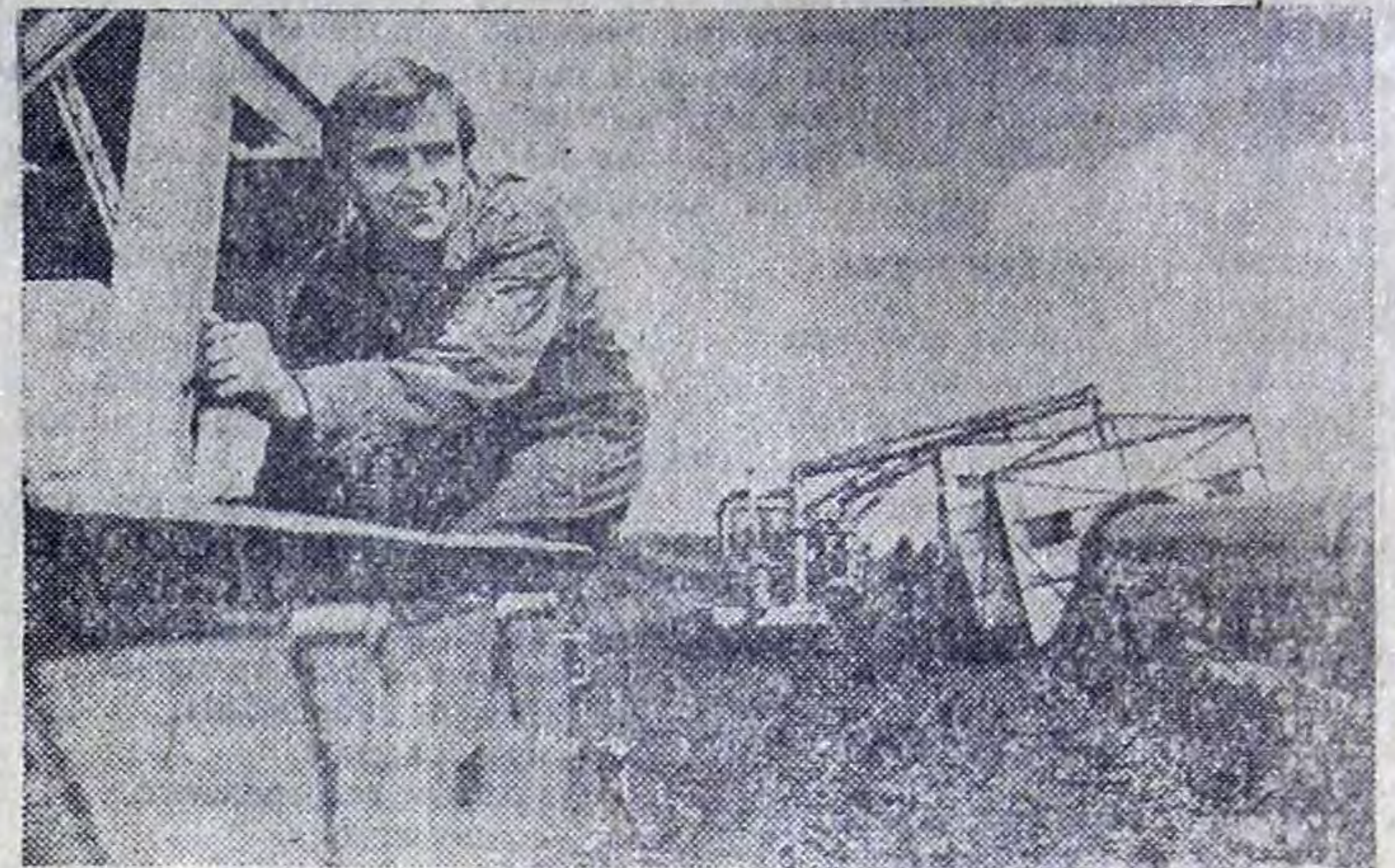
В нынешнем году польским специалистам предстоит уложить еще десятки километров труб. На снимке: оператор Люциан
